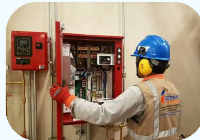
Redes contra Incendio y Detección y Alarmas
